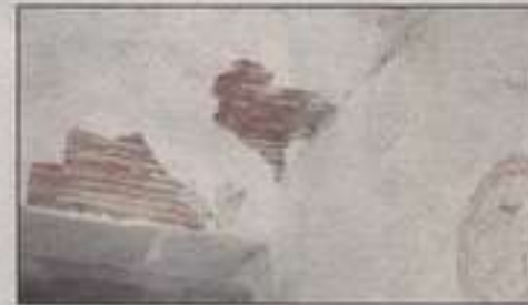
Des plaques du plafond se détachaient.
